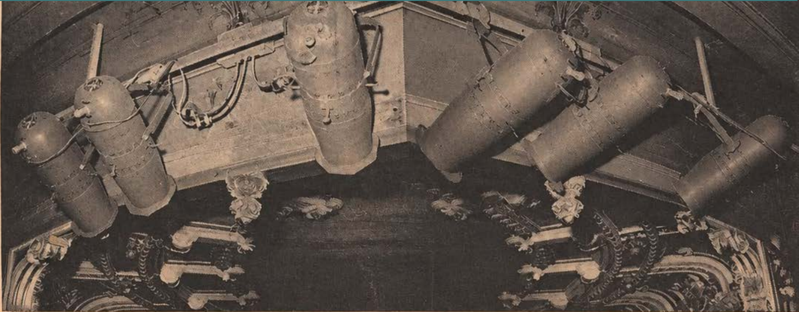
Parte de la batería de reflectores para enfoque desde el tercer piso. En total esta batería está integrada por 18 reflectores de 1000 watts cada uno.
